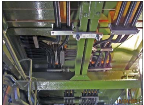
Die Verkabelung wurde in Nürnberg gefertigt und vor Ort eingebaut. Aufnahme: 15. April 2011 - Ulrich von Stockhausen
