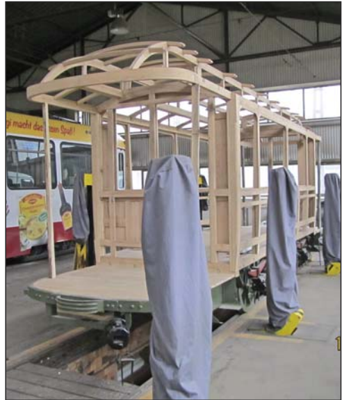
Dank der präzisen Vorarbeit war das Holzgerippe des Wagenkastens innerhalb von zehn Tagen aufgebaut.
